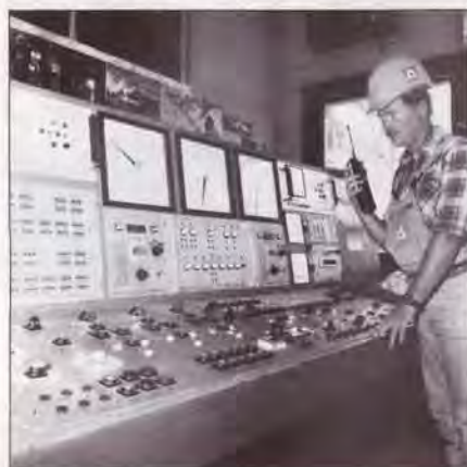
Steuerpult der Mischanlage.
